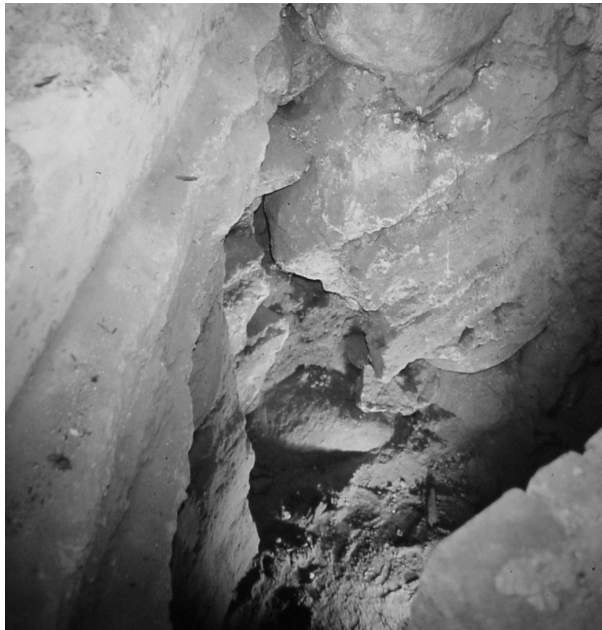
Rys. 6 Pustki i szczeliny wewnątrz kamiennej podstawy filara.
