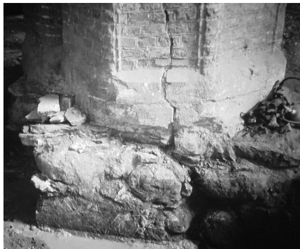
Rys. 4 Pęknięta podstawa filara we wschodniej części kościoła (na spodzie fundamentu widoczne górne głazy polodowcowe)
